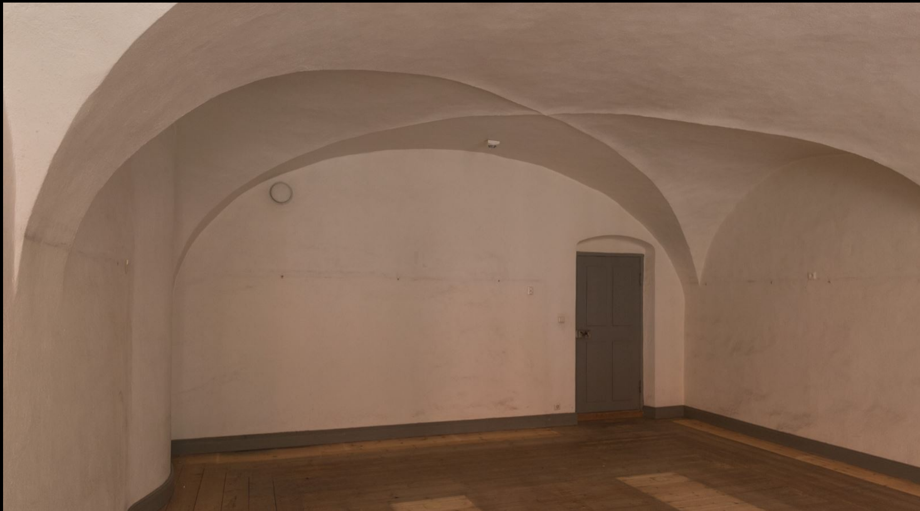
Placering av brandlarmsdetektor i komplicerade rumsmiljöer
