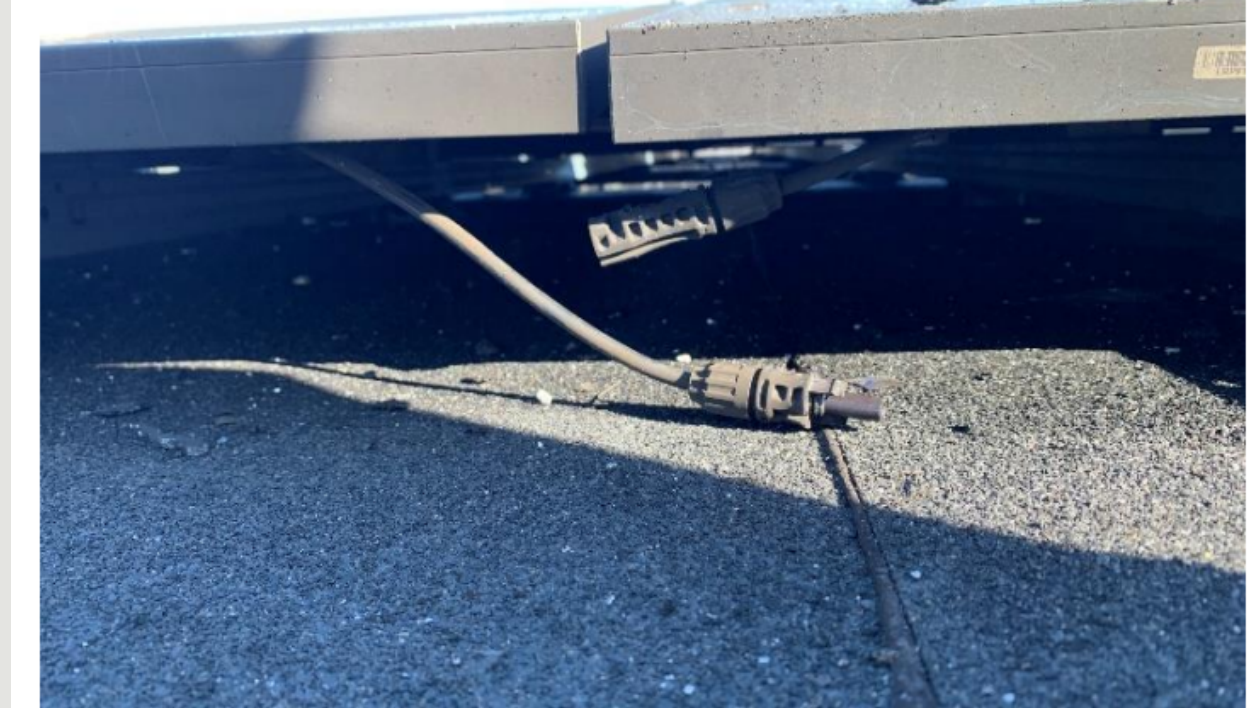
Figur 7. En av de kopplingar som kopplats bort.
