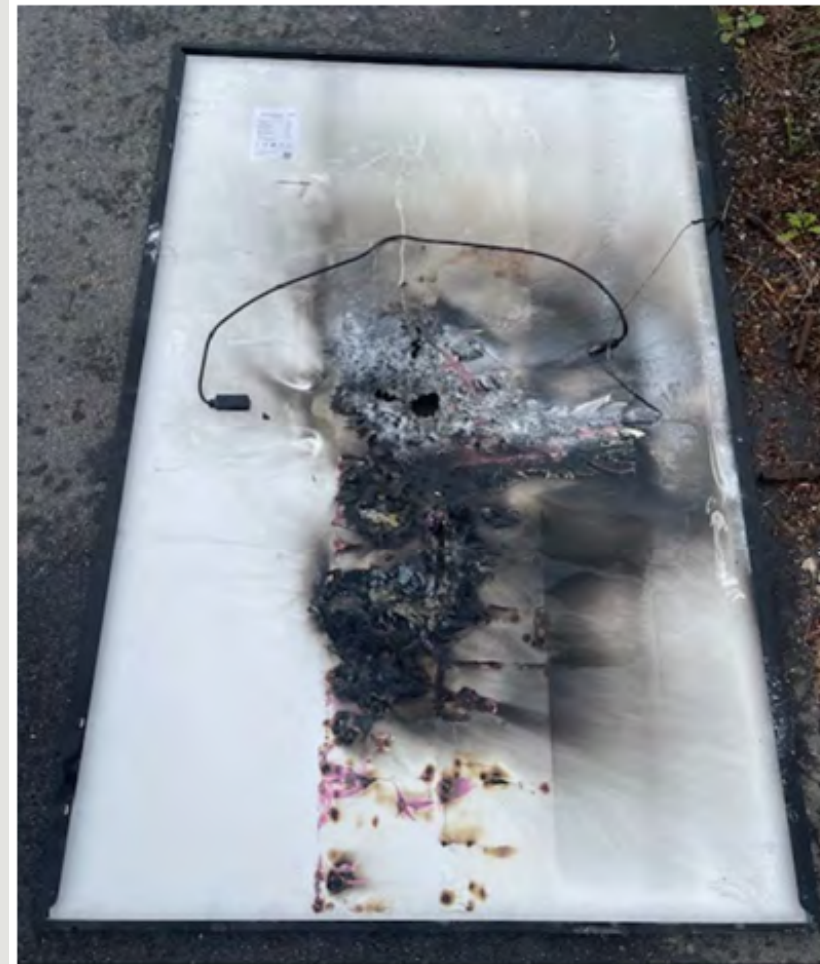
Figur 6. Baksida av solpanel som branden inträffade i.
